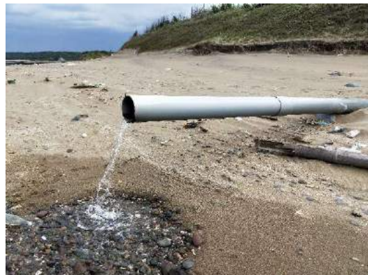
照片 4-2-12 私設水管排水
